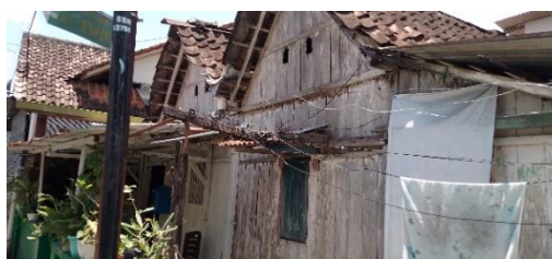
Gambar 6. Tidak adanya lisplang pada sebagian bangunan di kawasan Pakualaman
